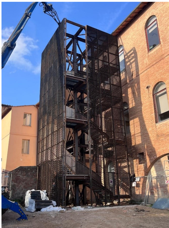
La scala antincendio a San Francesco(iniziata)
